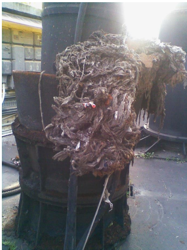
2. kép, Dugult, üzemképtelenné vált szivattyú
